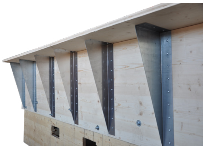
Fig. 7: Exemple du type d'acrotères 4.6, photo prise lors du test pratique
